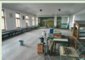
Současný havarijní stav
