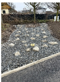
Drenážní pás Kaštanová
